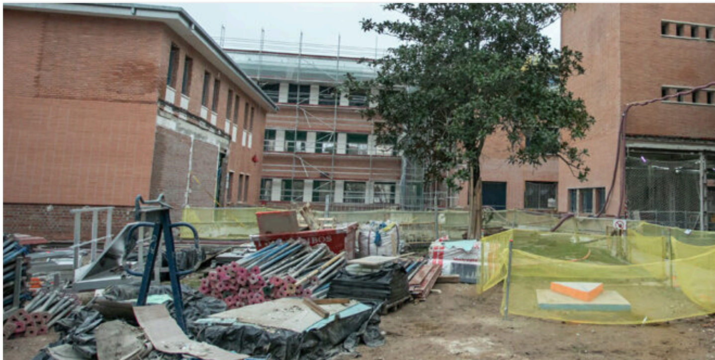
Fotografía del estado de las obras del campus de la UAH en Guadalajara. Imagen de Piedad López. JCCM
