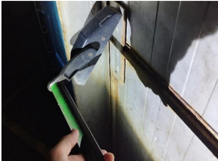
Fotografías aportadas por Alternativa Sindical a Inspección de Trabajo. Barra antipánico desclavada de la puerta
