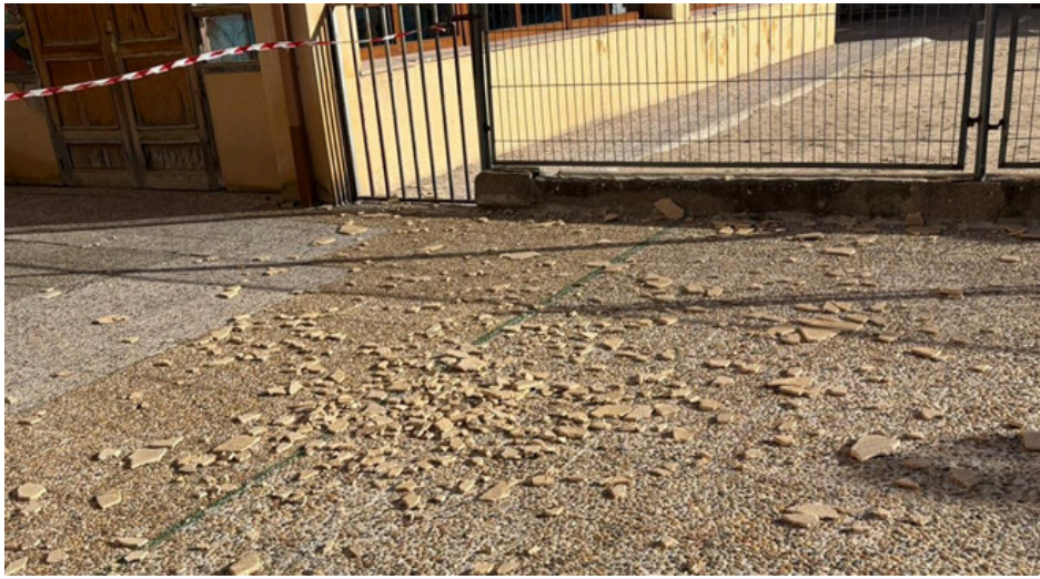
Salida que se tuvo que cerrar tras el desprendimiento del enfoscado
