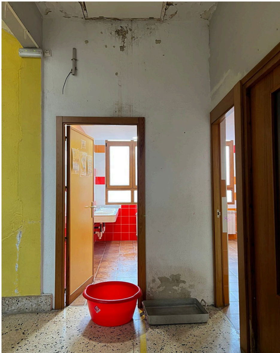
Las goteras en el techo y humedades en las paredes son visibles en varias zonas del colegio público san Antonio de Portaceli, de Sigüenza
