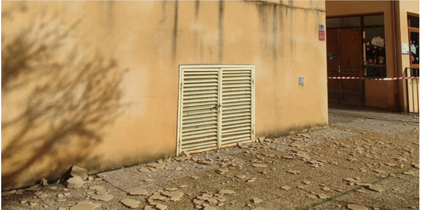
Restos del enfoscado de la pared del colegio de San Antonio de Portaceli, en Sigüenza
