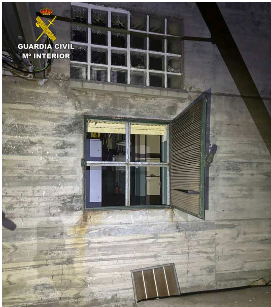
Caseta del repetidor de telefonía de Sigüenza que forzaron para sustraer el cable de cobre del interior
